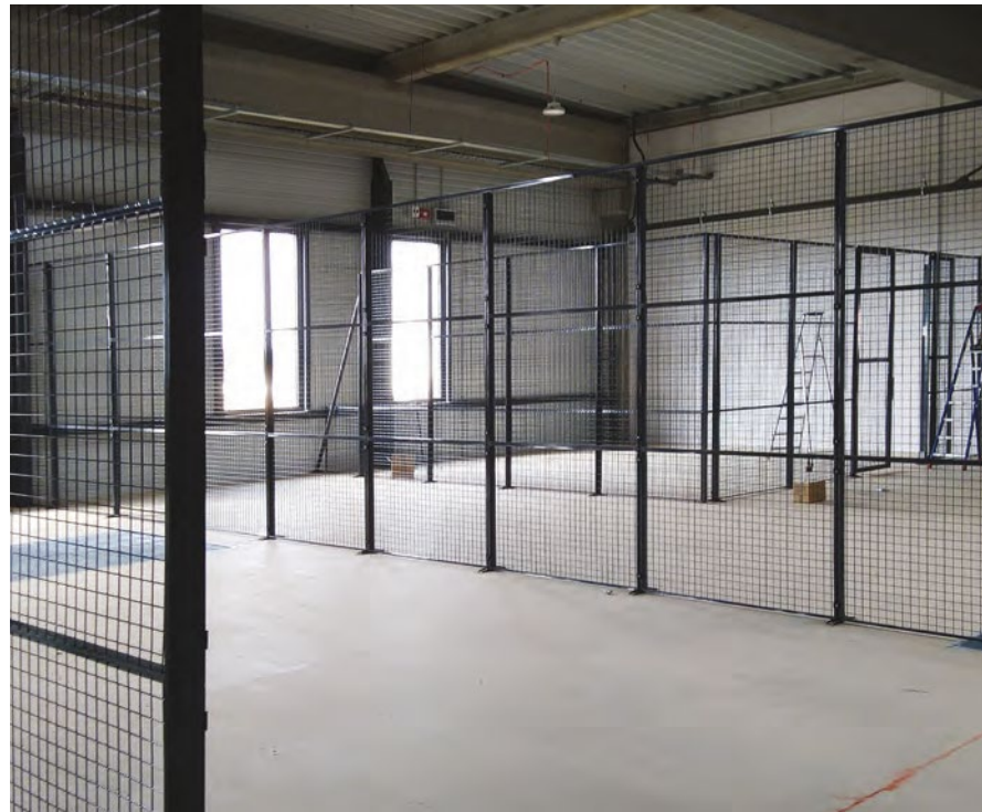
Création de zones spécifiques pour le stockage de marchandises précises et éviter le mélange de provenance des matériaux (GBG Concept)
