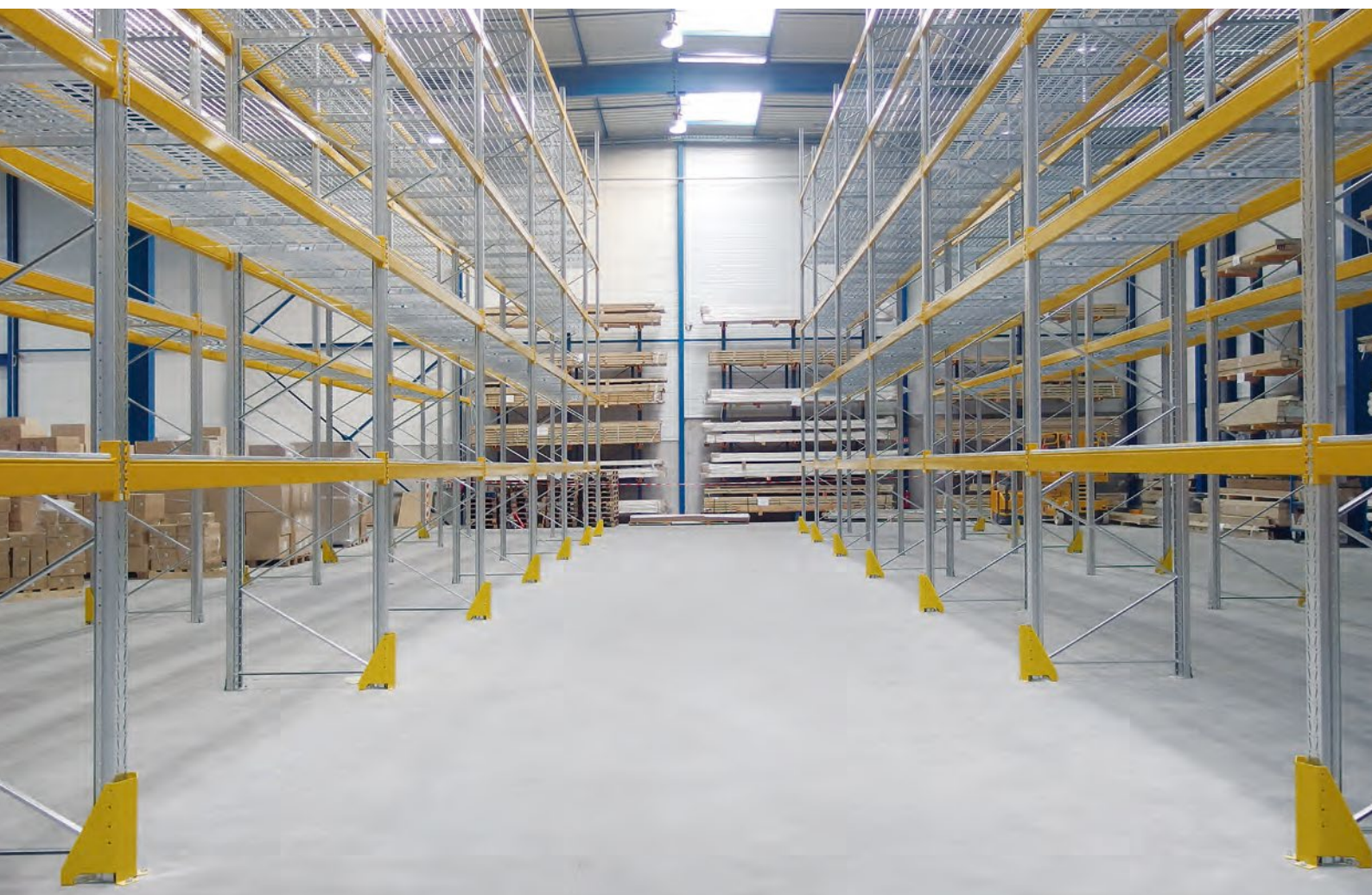
Installation avec platelages caillebotis pour entrepôt équipé de têtes de sprinklage (Adetech)
