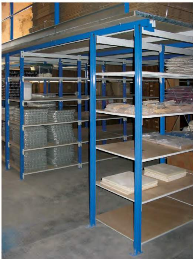
Installatie van stellingen ACTI-PLUS met legborden bekleed met 8 mm spaanplaat voor de opslag van onverpakte producten zoals tegels, zakken grondstoffen en platen (Adetech)
