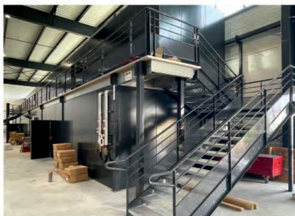
Controledoorloopvlak, geïnstalleerd boven machinezones met toegang voor publiek en personen met beperkte mobiliteit (GBG Concept)
