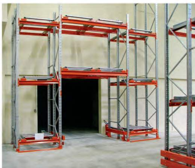
Implementatie van een 'push back' oplossing om meer pallets op te slaan in een compacte opslagruimte (Gallorema)
