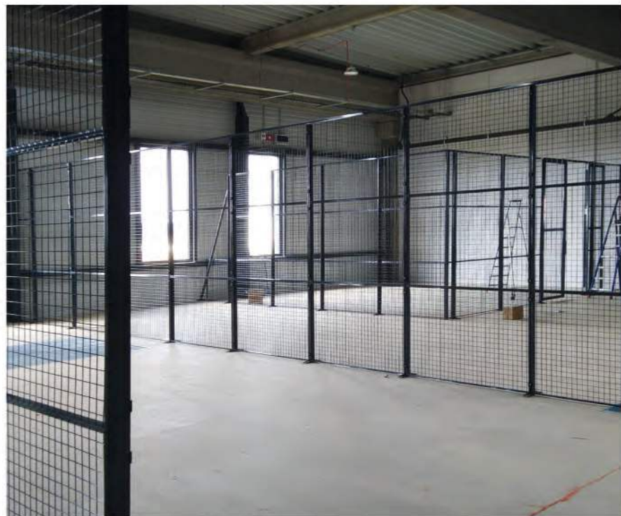
Creëren van specifieke zones voor de opslag van specifieke goederen, en om vermenging van de herkomst van materialen te voorkomen (GBG Concept)
