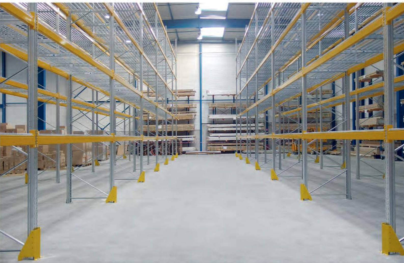
Installatie met roosterlegborden voor magazijn uitgeruste met sprinklerkoppen (Adetech)
