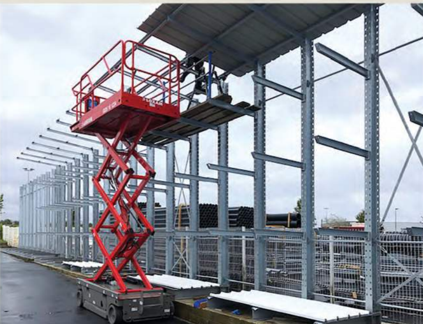
Installatie buiten tijdens montage, met corrosiebestendige thermisch verzinkte stalen kolommen en armen (GBG Concept)
