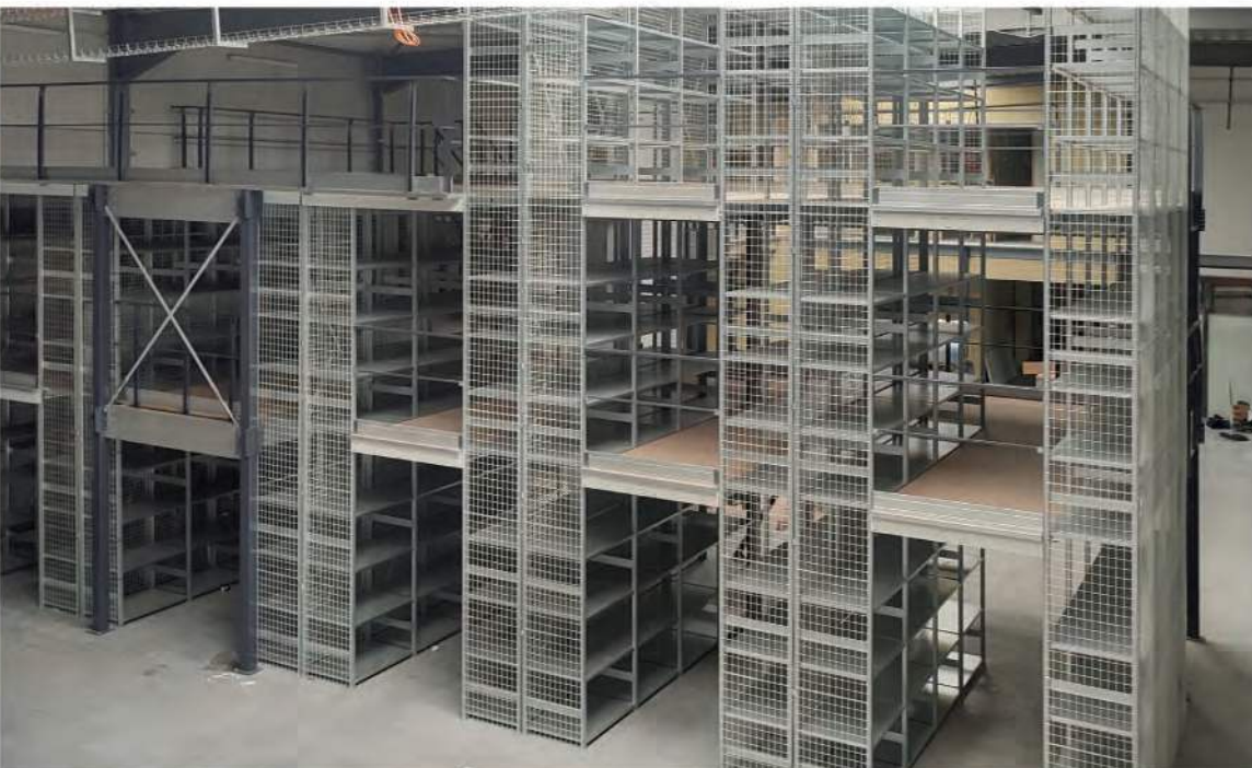
Opberg ruimte gestructureerd op 4 etages om het vloeroppervlak zo klein mogelijk te houden. Aanzienlijke kostenbesparing per m 2 (DDI)
