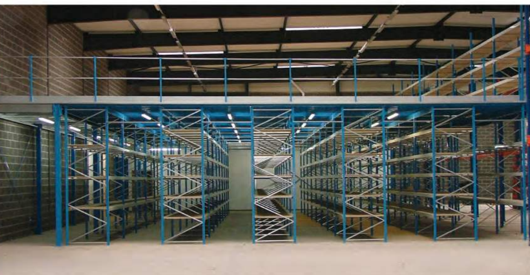
Optimaliseren van de oppervlakte van een onderdelenmagazijn met een structuur van diepe ACTI·VOL-stellingen (Gallorema)
