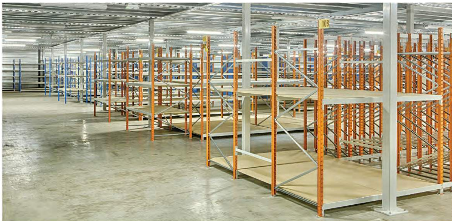
Meerdere installaties in een magazijn voor de opslag van verschillende soorten producten en volumes
